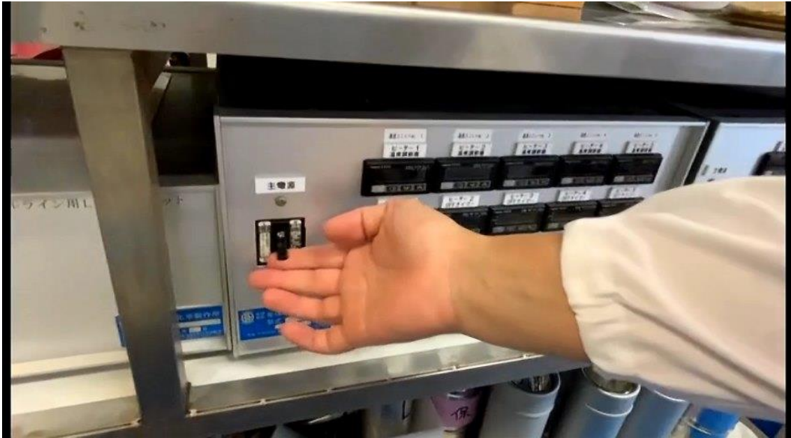
⑫ヒーターの主電源を ON。
